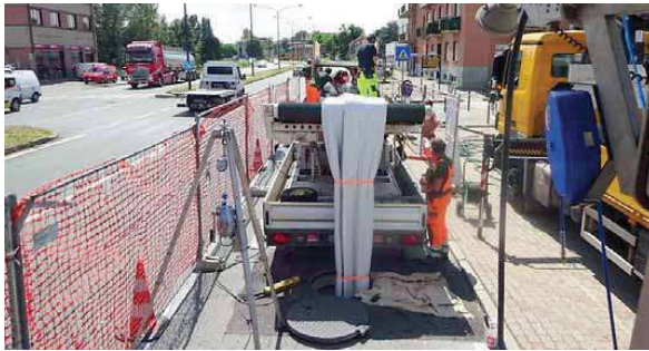
Gli addetti della Rotech Srl al lavoro sulle condotte idriche di Milano
