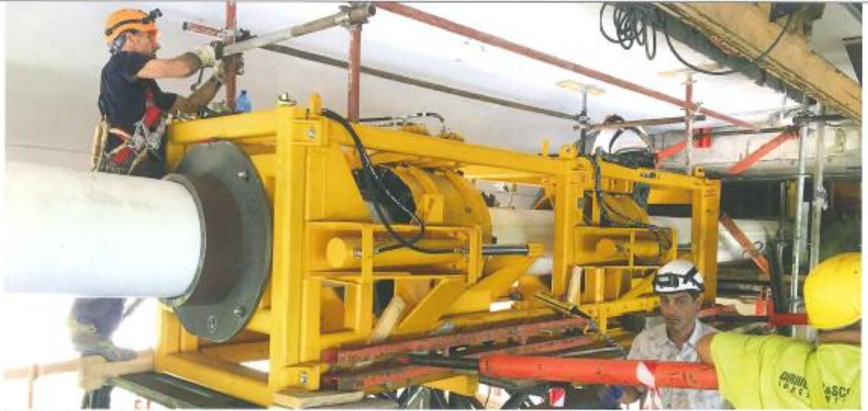
Das Gesenk mit zwei Pushern wurde in Höhe der zu sanierenden Leitung auf einem Arbeitspodest installiert und gegen den Brückenkörper verspannt.
