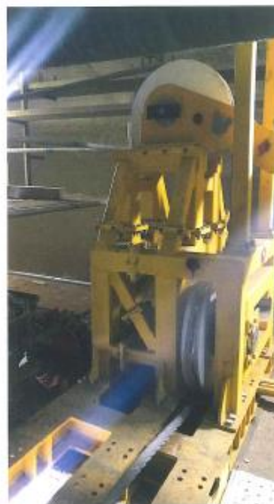
90°-Umlenkungen des Windenseils im Brückeninneren | Fotos und Abbildung: Düringer & Scheidel Rohrsanierung
