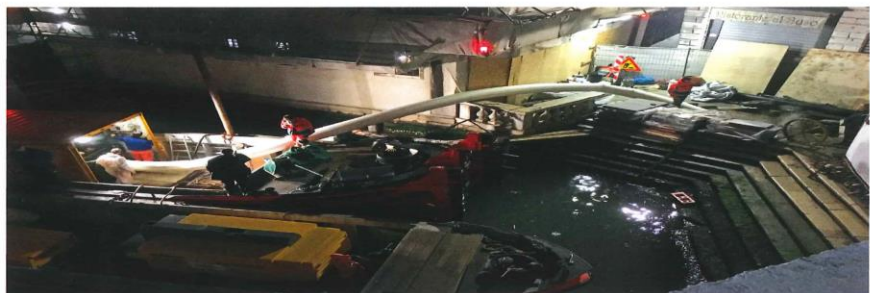
Aufgrund der räumlichen Verhältnisse konnte die Inversionstrommel nicht in der Achse der Rohrleitung positioniert werden; deshalb musste der BlueLiner aus der Inversionstrommel heraus in einem weiten Bogen zur Leitung geführt werden.
