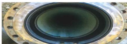
Das Ergebnis der erfolgreichen Sanierung: ein neues Rohr, dessen Standard und Qualität den hohen Anforderungen einer Herstellung im Werk entspricht. | Fotos: Diringel & Scheidel Rohr-sanierung
